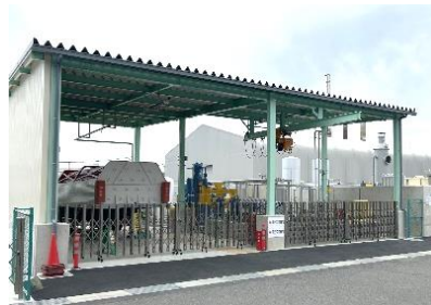
水素供給設備の外観
